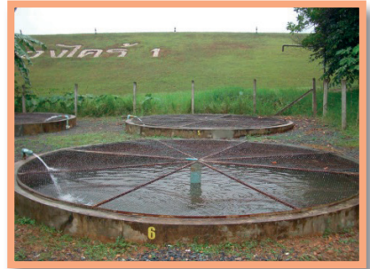
บ่อซีเมนต์กลมระบบน้ำไหลผ่าน
